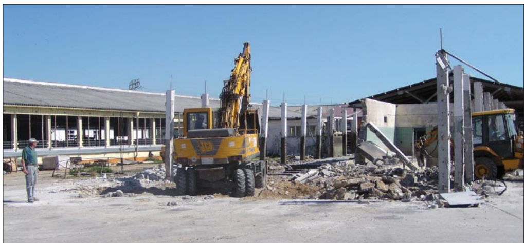
Abriß des alten Melkstandes und Milchhauses Ende August 2006. Auf dieser Fläche wurde der neue Teil des Stalles errichtet.
