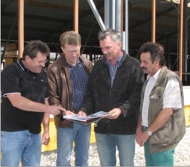
Das eingespielte Bau-Team (von links): Vorstandsvorsitzender Gerhard Schladitz, Bauingenieur Dr. Siegbert Kiep, Heinz-Jürgen Keup von der Hartmann Brehna GmbH sowie zweiter Vorstand Udo Erdmann.
